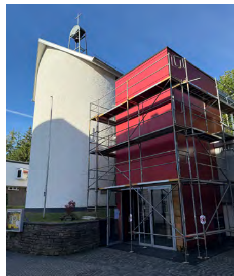
Die marode Außenfassade muss leider saniert werden.
